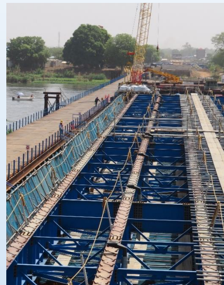
日本の支援によるジュバのFreedom Bridge建設現場(2019年3月、東教授撮影)
